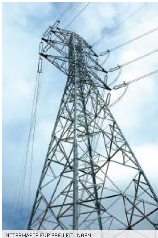
GITTERMASTE FÜR FREILEITUNGEN
